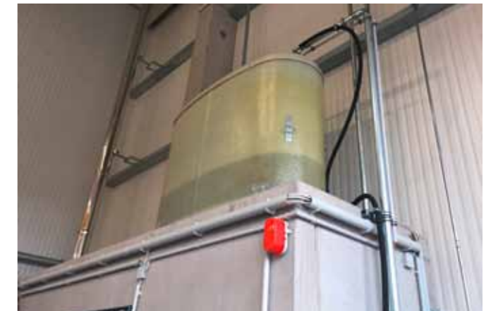
Auf einem Podest in der Werkstatthalle in Hamburg montierter Tank für das anfallende Altöl
