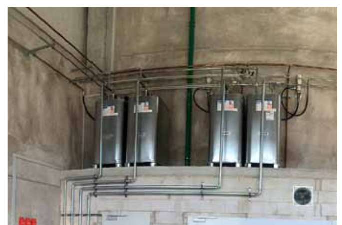
1000-l-Tanks mit Hochdruckverrohrung und Kolbenpumpen PumpMaster 2 DP 3:1 plus mit 42 l/min Förderleistung
