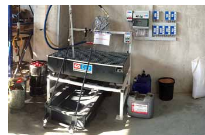
Zentrale Altölsammelstation mit Füllstandsüberwachung und vollautomatischer Entleerung in den Altölsammeltank
